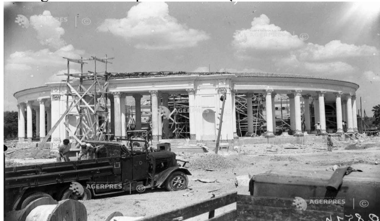
Figura nr. 1.10. - Imagine de la începutul construcției Teatrului de vară Nicolae Bălcescu
