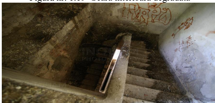
Figura nr. 1.19 -Scară interioară degradată
